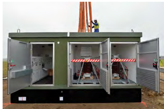
Bild 3: Einsatz im Mittelspannungsnetz
