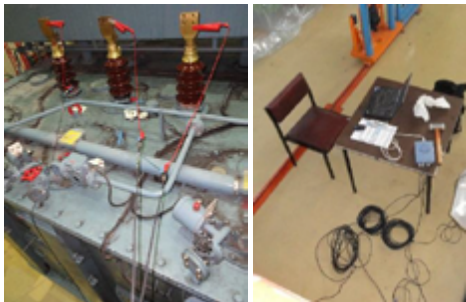
Bilder 2&3: Messungen entsprechend WCE- Verfahren an einem 75MVA- Ofentrafo während der Eingangsprüfung im Werk
