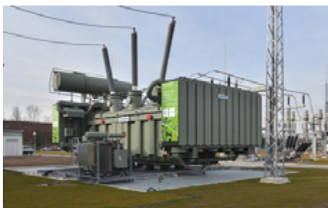
Bild 8: 380kV Transformator im Umspannwerk Bruchsal-Kandelweg der TransnetBW
