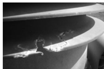
Bild 3: Schirmerosion an einem 420 kV Stromwandler nach kurzer Betriebszeit [5]
