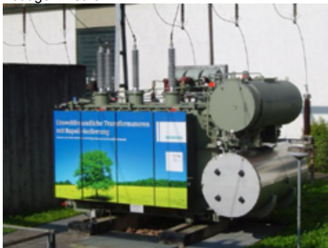
Bild 5: 110kV Transformator im Umspannwerk Teinach der Netze-BW
