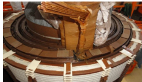
Bild 7: Die OS- Stammwicklung W (die mittlere Wicklung, außen befindet sich die US) verfügte über keinerlei Presskraft mehr. Das Wicklungsende/ ihre oberste Winding konnten sich erkennbar nach links/ im Uhrzeigersinn verschieben.
